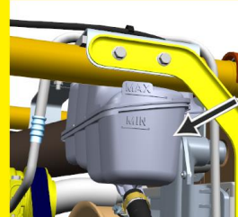
检查冷却液液位 (风扇上方)
